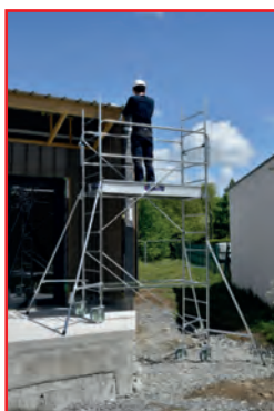
Installation en dénivelé intégrée
